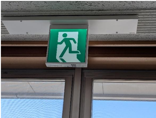
LED 非常誘導灯
