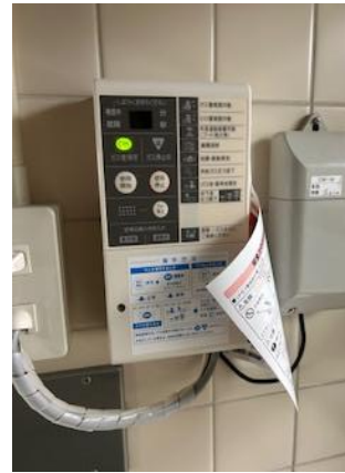
【1階ガス遮断弁・コントローラー】
