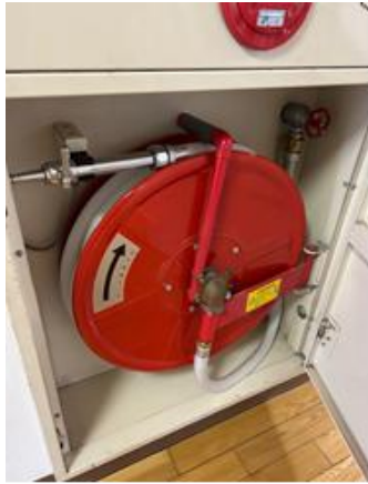
【消火栓ホースリール】
