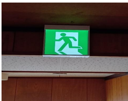
【非常用照明器具】
