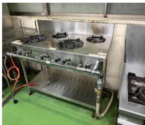
【厨房ガステーブル】
