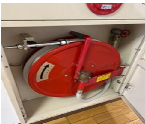
【消火栓ホースリール】
