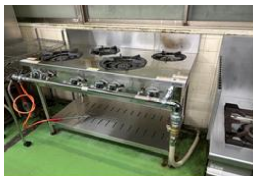
【厨房ガステーブル】
