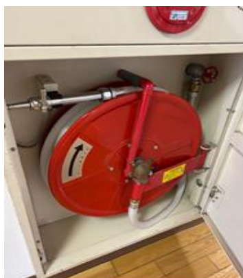
【消火栓ホースリール】
