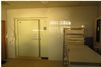
厨房プレハブ冷蔵庫
