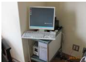
PC サーバー設備
