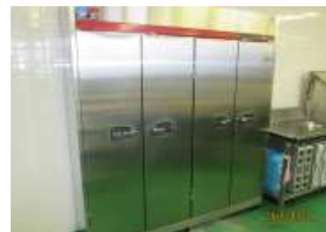
食器消毒保管庫
