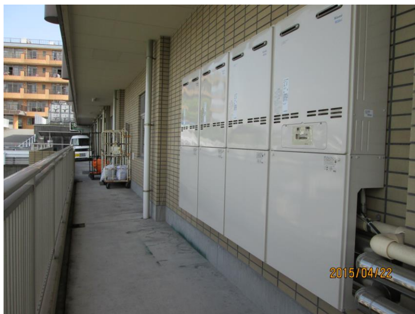
更新ボイラー設備
